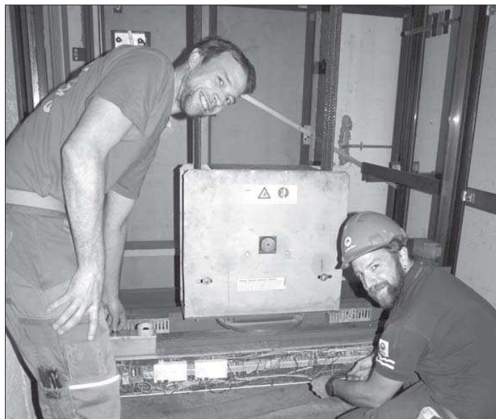
Seppi Imgrüth vom EWS (links) und Bruder Marcel Imgrüth (Liftmonteur bei der Firma Schindler) schauen auf dem Dach des Bettenliftes nach dem Rechten.
